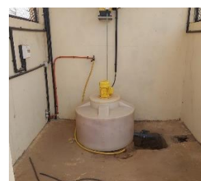
Système de déferrisation non fonctionnel du forage de Bala à changer
